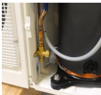
Figuur 26: Schraeder aansluiting in de vloeistofleiding
